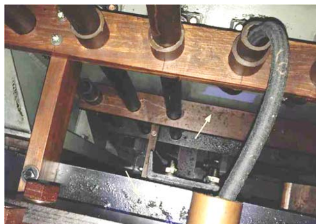
Abbildung 8. Endoskopische Untersuchung des Transformators im Februar 2020
