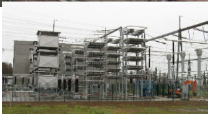
Kompensationskondensator (Umspannwerk Engstlatt)
