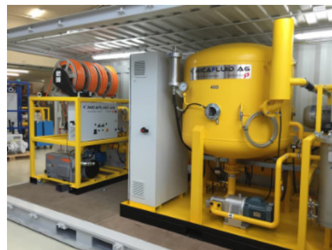
Ölaufbereitungsanlage von Hitachi Energy
