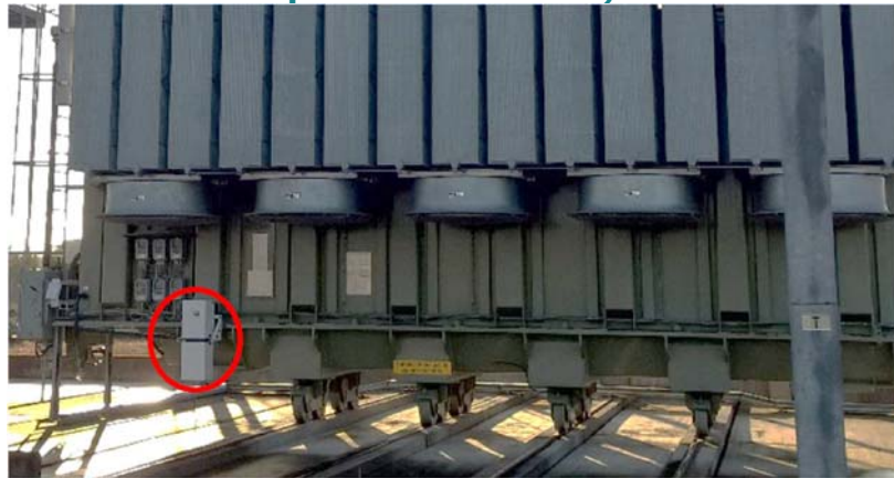
Abbildung 15. Aufstellung des Online Monitoringsystems
