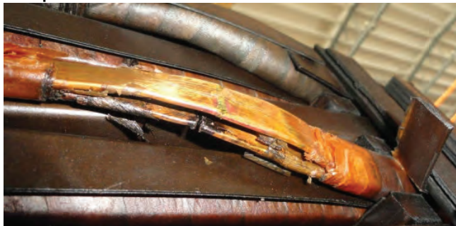
Teilleiterunterbrechung, nicht in DGA auffällig
